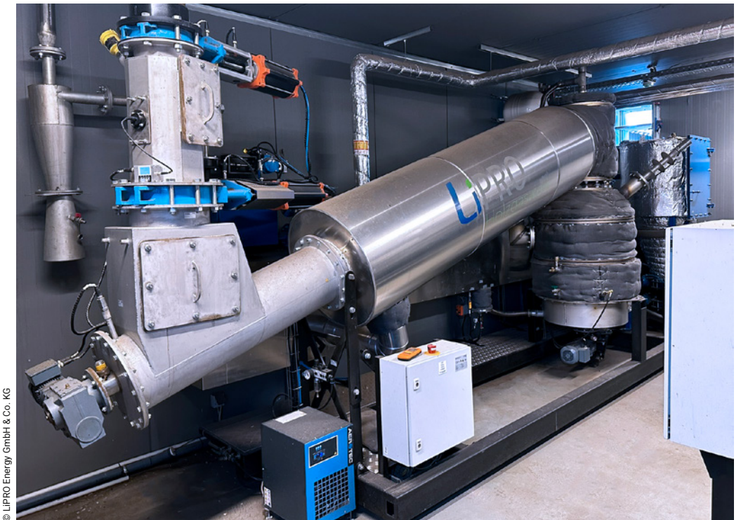
Abb. 41: Holzgas-BHKW des Projektpartners LiPRO Energy
