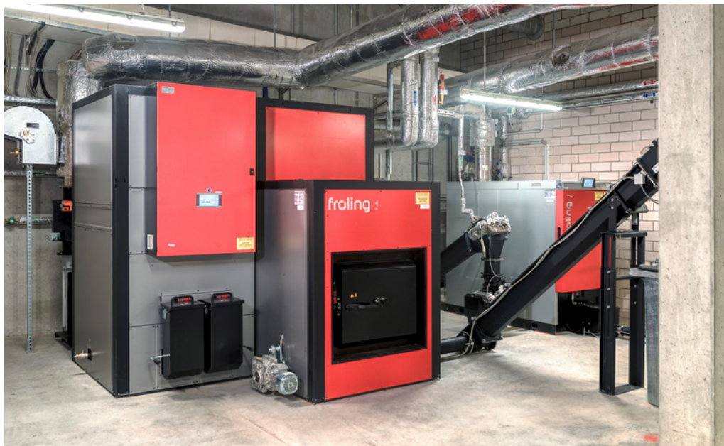
Abb. 14: Holzhackschnitzelfeuerung im Technikum des DBFZ
