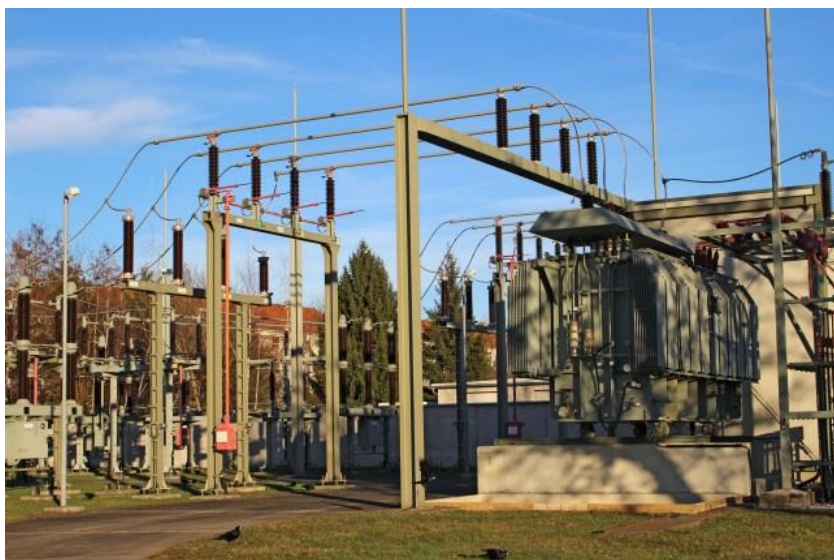
Abbildung 1: Umspannwerk in Leipzig-Eutritzsch (Foto: DBFZ)
