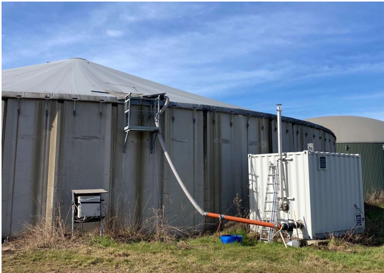
Gesamtansicht: Gasförder- und Messstation (GFMS)
