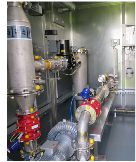
Innenansicht: Kondensatfalle, Gebläse, Strömungssensor, Pronova Gasanalyse
