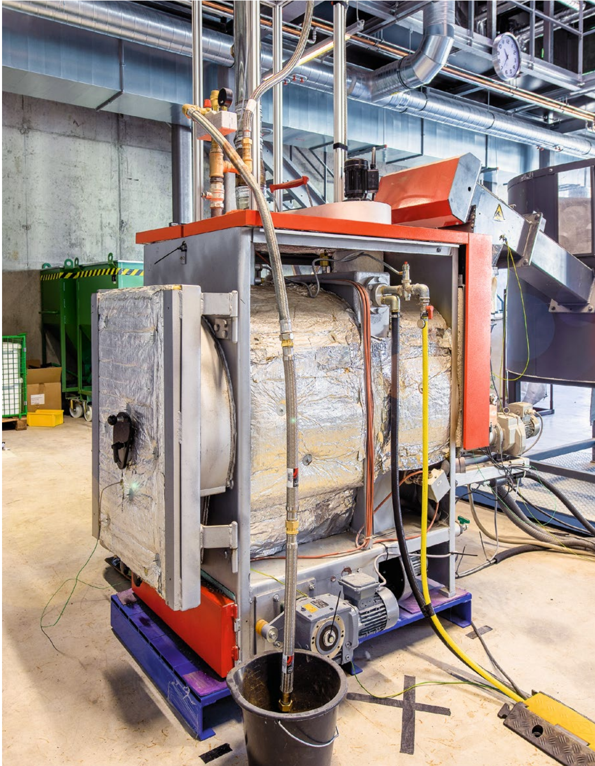
Abb. 19: Technikumsversuchsanlage zur Herstellung von biogenem Silica aus Hafer- und Dinkelspelzen, Typ Oekotherm 49 kW
