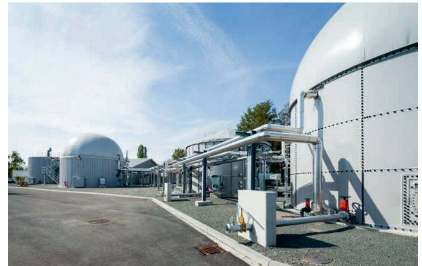
Abb. 48 Die Forschungsbiogasanlage des DBFZ
