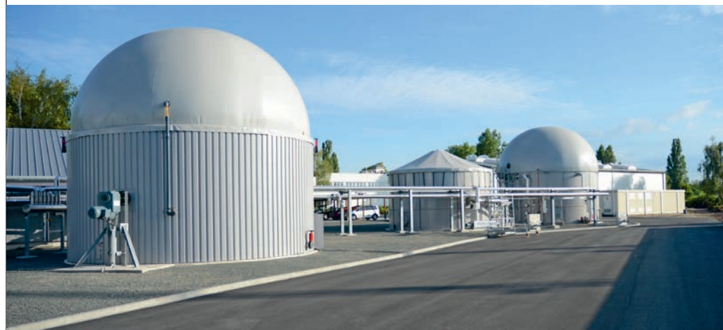
Abb. 6 Forschungsbiogasanlage des DBFZ (Rührkesselfermenter mit Doppelmembrangasspeicherdach vorne links)
