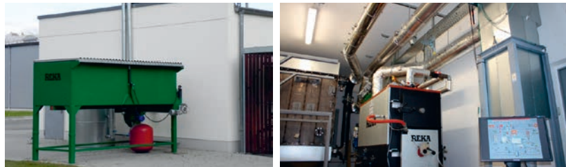
Abb. 13 Versuchsanlage Außenansicht (links) und Innenansicht (rechts)
