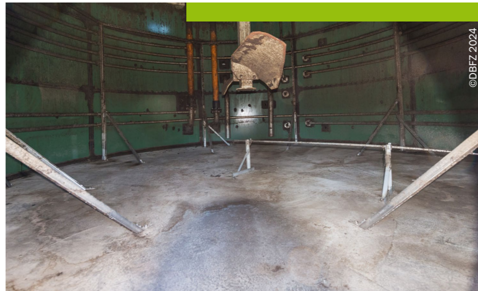
Abbildung 4: Darstellung der Anlagentechnik im Behälterinnenraum im entleerten Zustand auf dem Gelände des DBFZ Deutsches Biomasseforschungszentrum gemeinnützige GmbH
